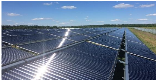
Installation solaire thermique pour un réseau de chaleur Source: BSW-Solar
